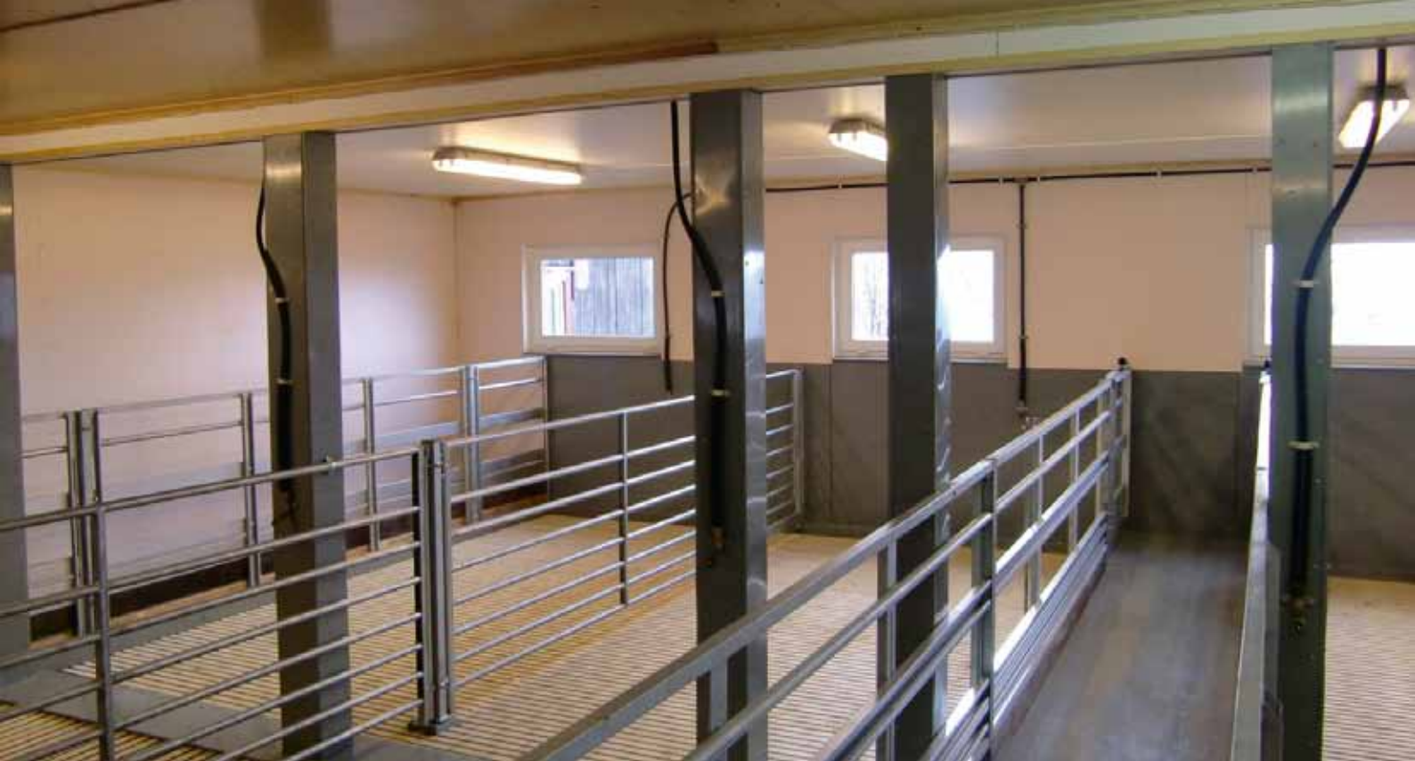
Orkla-Sørbøen på øvre del av vegg og i himling. Kompakte plastplater brukt alle steder som er utsatt for gnag. Dvs forbrett, nedre del av vegg og tresøyler.
